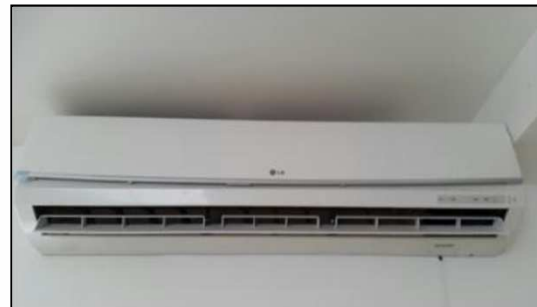
Aire de 24000 BTU para Facturación Urgencias
