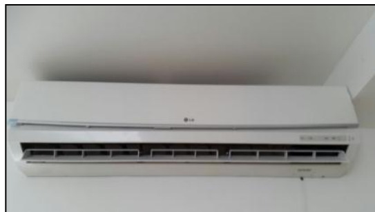
Aire de 24000 BTU para Facturación Urgencias
